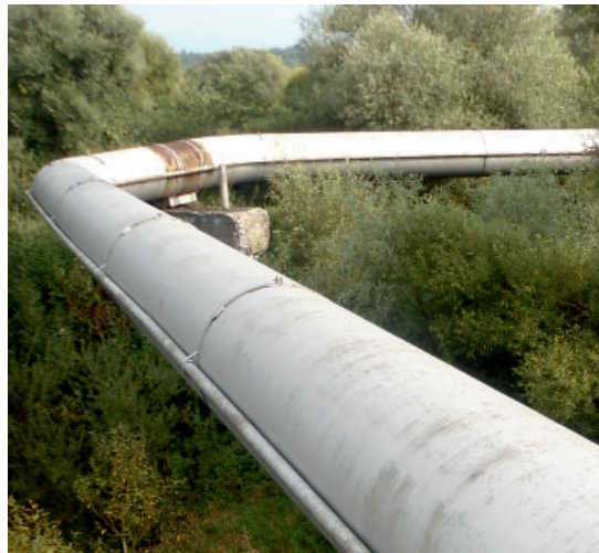
Рис. 1. Надземна ділянка магістрального газопроводу з компенсатором і рухомою опорою
