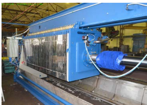
Рис. 1. Фільтрпрес ЧМ80, ГЗК «Східний» Згущені шахтні води
