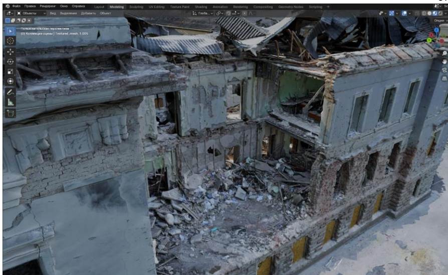
Рисунок 3. Пошкоджені конструктивні та фасадні елементи пам'ятки архітектури
