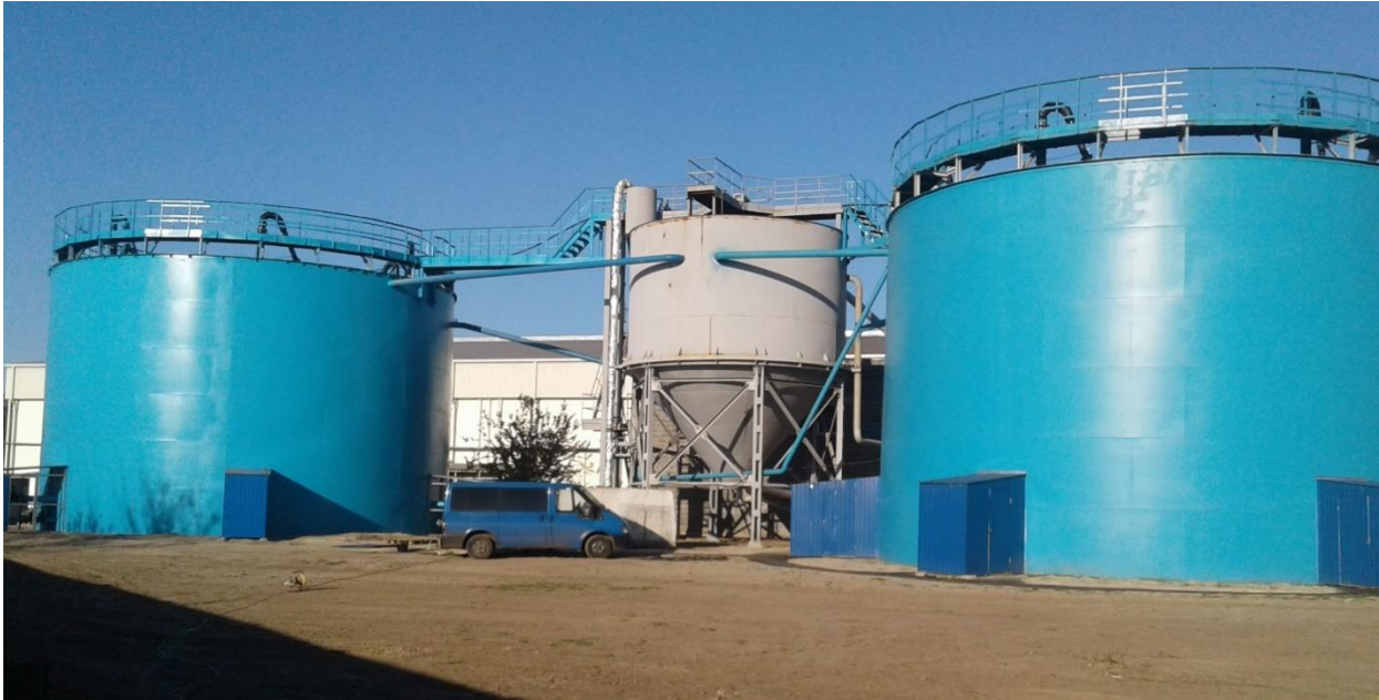
Рис. 1. Споруди попередньої очистки стічних вод Золотоніського маслоробного комбінату
