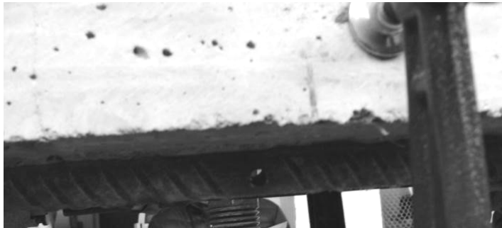
Рис. 3. Пошкодження у вигляді отвору в розтягнутій арматурі
