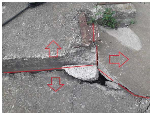
Рис. 3. Тріщини та деформації, що проявляються у тілі греблі Дністровської ГЕС-1 (осінь 2019 р.)
