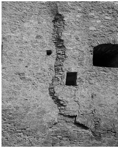
Рис. 3. Одна з розколин в мурі п'ятикутної башти, яку заповнено кладкою під час ремонту (фото автора)
