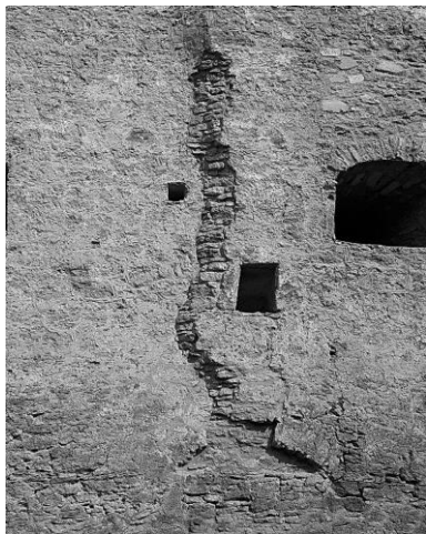
Рис. 3. Одна з розколин в мурі п'ятикутної башти, яку заповнено кладкою під час ремонту (фото автора)
