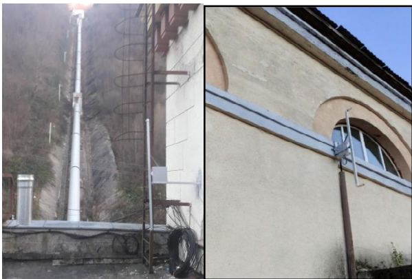
Рис. 6. Метеостанції із температурним градієнтнометром на будівлі ГЕС та на дросельному затворі
