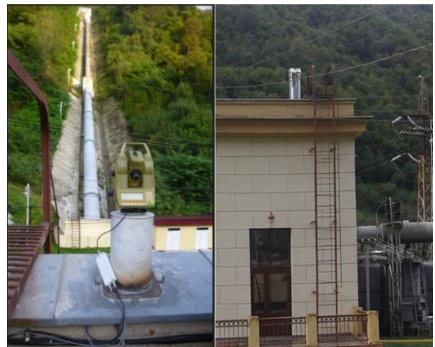
Рис. 4. Роботизований тахеометр LEICA TPS1000 із захисним ковпаком, встановлений на даху машинного залу
