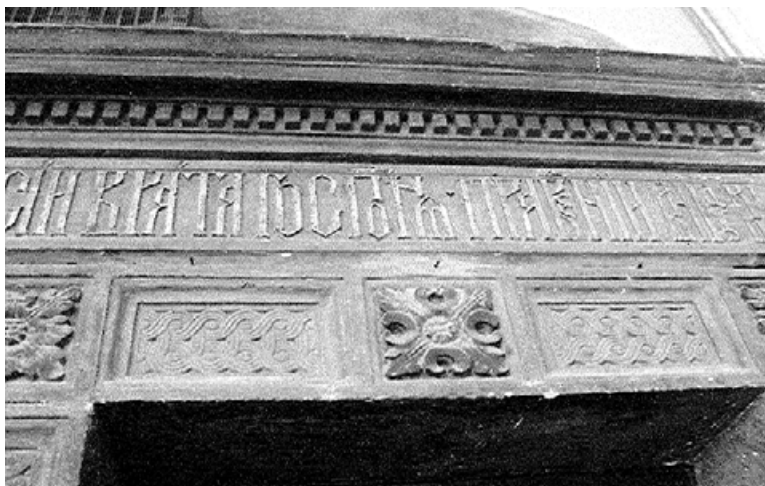
Рис. 4, б. Фрагмент порталу з пошкодженим карнизом
