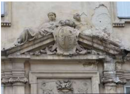
Рис.9. Скульптурна група на вул. І. Франка, 2. Руйнування внаслідок замокань фасаду. Фото - А.Федоришин.
