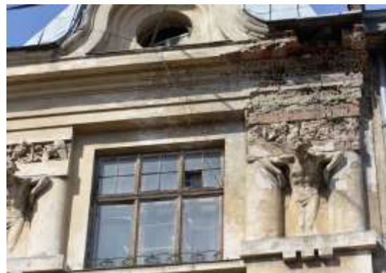
Рис.10. Атланти та рельєфи на вул. Генерала Чупринки, 6. Руйнування внаслідок замокань фасаду. Фото - А.Федоришин.
