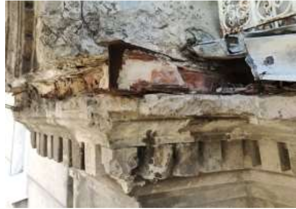
Рис.14. Алегоричні скульптури на вул. П. Дорошенка, 19. Руйнування внаслідок корозії двотаврів. Фото - А.Федоришин.
