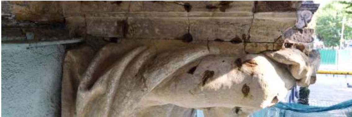
Рис.17. Атланти та каріатиди на вул. Листопадового Чину, 12. Процес стабілізації тріщин. Фото - А.Федоришин.
