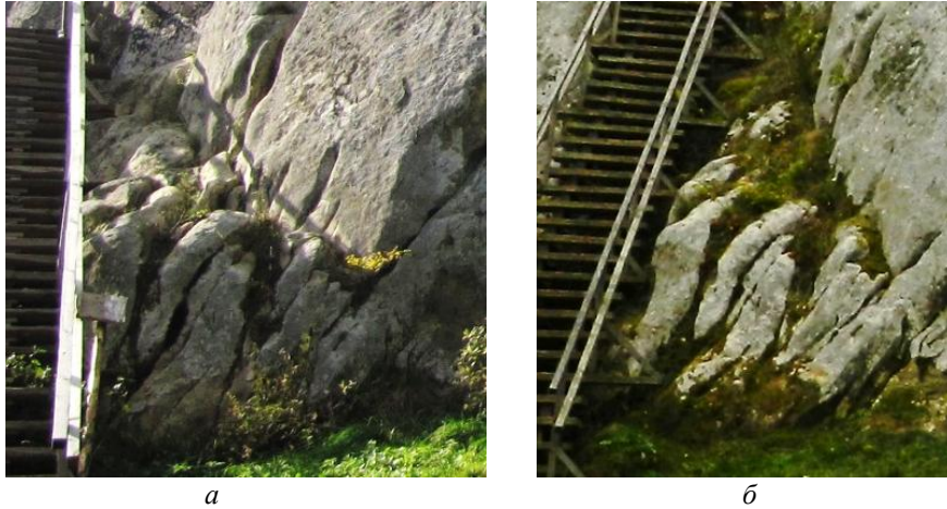
Рис. 5. Зростання рослинного покриття в тріщинах на стінці південно-східної експозиції масиву “Камінь”: а – 2011 р., б – 2023 р.
