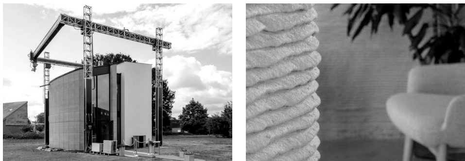
Рис. 4. Двоповерховий будинок «Катр С» в Бельгії (2020). Тривимірний друк бетону на місці: новий спосіб будівництва будинків. Університет Ghent, Veneens Construction & Interior, Saint-Gobain Weber Veatix. 3D-друкований будинок з різними стратегіями ізоляції. Загальний вигляд спереду; елемент стіни в розрізі
