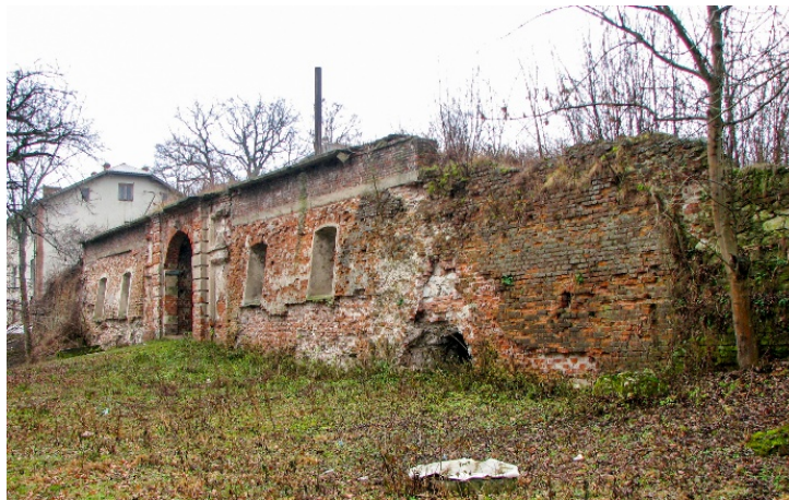
Рис. 5. Деструкція облицювання головного фасаду брами та прибрамного корпусу. 2012 р.
