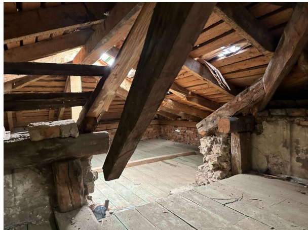
Рис. 11. Пошкоджені дерев'яні конструкції даху - крокви (фото І. Бокала, 19 вересня 2024 р.)
