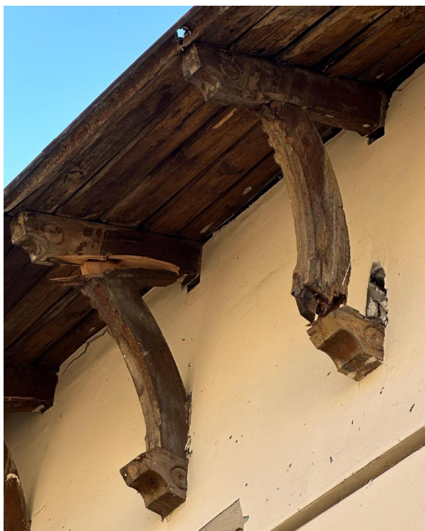
Рис. 8. Пошкоджені дерев'яні декоративні деталі звису даху з північно-східної сторони будинку (фото І. Бокала, 23 вересня 2024 р.)
