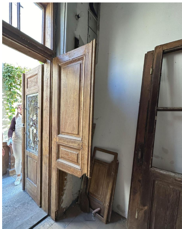
Рис. 9. Пошкоджені тахльовані двері головного входу (фото М. Каплінської, 19 вересня 2024 р.)
