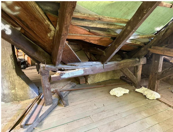
Рис. 10. Пошкоджені дерев'яні конструкції даху - прогони (фото М. Каплінської, 19 вересня 2024 р.)
