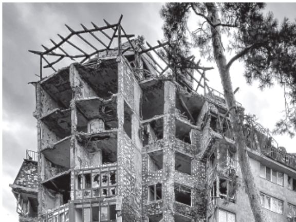
Рис. 8А. Панельні будівлі. Наслідки ракетного удару залежать від точки влучання і детонації. Джерело: Микола Кондрашев / Катерина Мала
